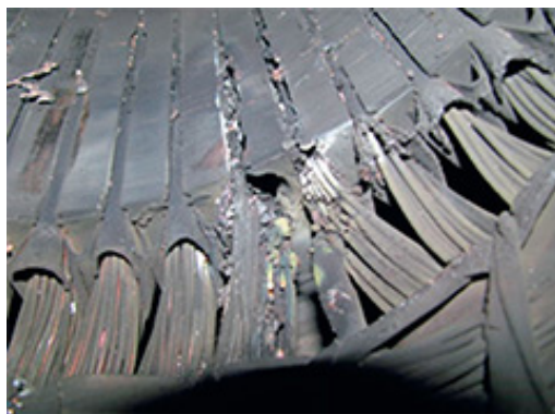
Figura 1. Núcleo con daño severo.
